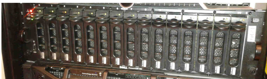
Rys. 4. Macierz SAN współpracująca z serwerem kasetowym
